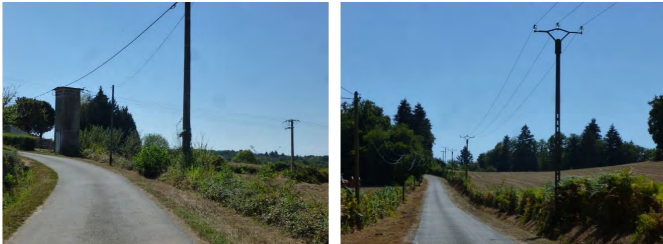
Photographie 18 : Lignes électriques HTA sur la ZIP (source : ENCIS Environnement)
